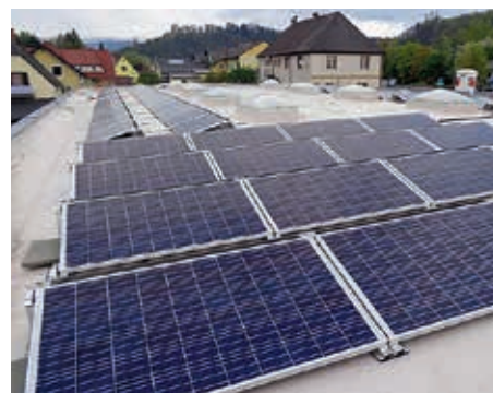
Zwei Photovoltaikanlagen sind auf dem Dach des LSI-Hauses installiert.
